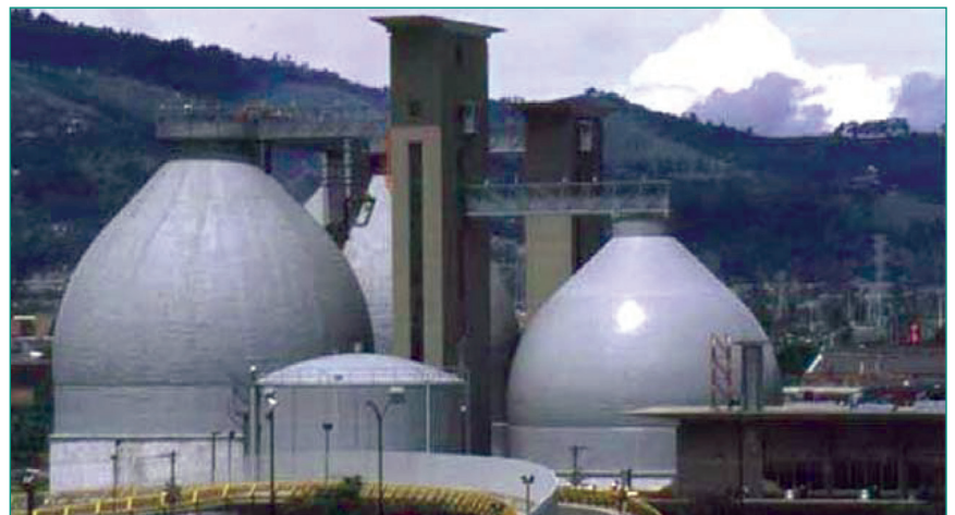
Fig.1: Anaerobic digesters at Empresas Publicas
