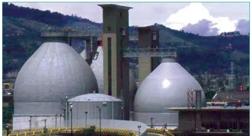
Fig.1: Anaerobic digesters at Empresas Publicas
